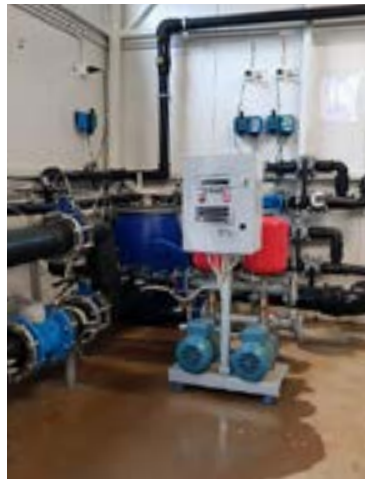
■ Stația modernă de filtrare
